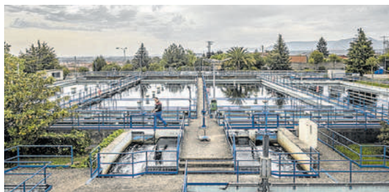
Estación potabilizadora de Logroño en Lardero. JUSTO RODRÍGUEZ
